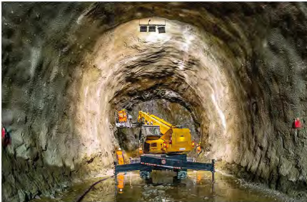
Maxi tunnel. Attualmente, sotto il passo del Brennero si sta costruendo quello che un giorno diverrà il collegamento ferroviario sotterraneo più lungo al mondo: 64 chilometri tra Fortezza e Innsbruck (Austria)
