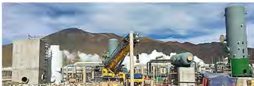
A 4.500 metri La centrale geotermica dell'Enel a Cerro Pabellón, nel deserto di Atacama (Cile) È entrata in funzione a marzo
